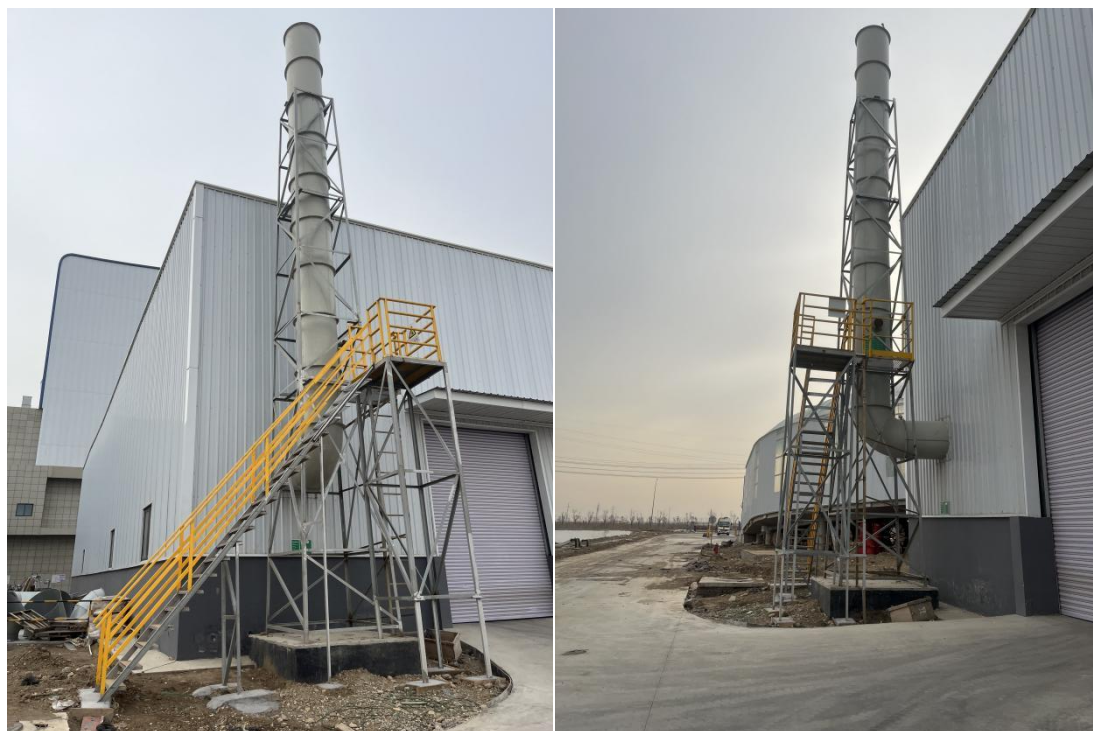
废气采样平台及采样口
