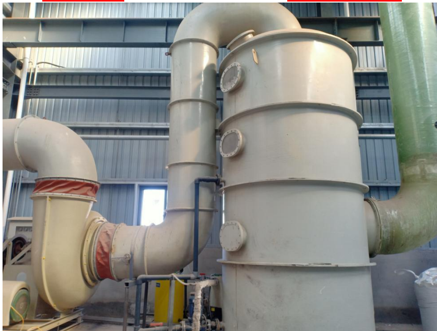
飞灰固化车间碱液喷淋装置
