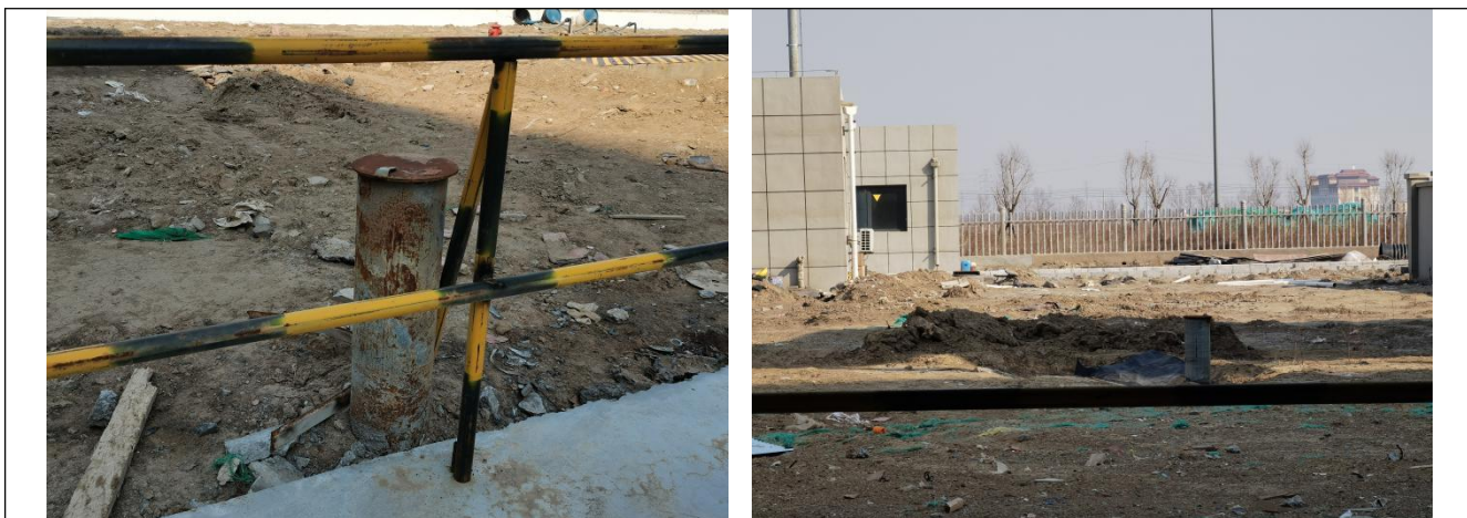
图 3.5-4 地下水监测井实拍图
