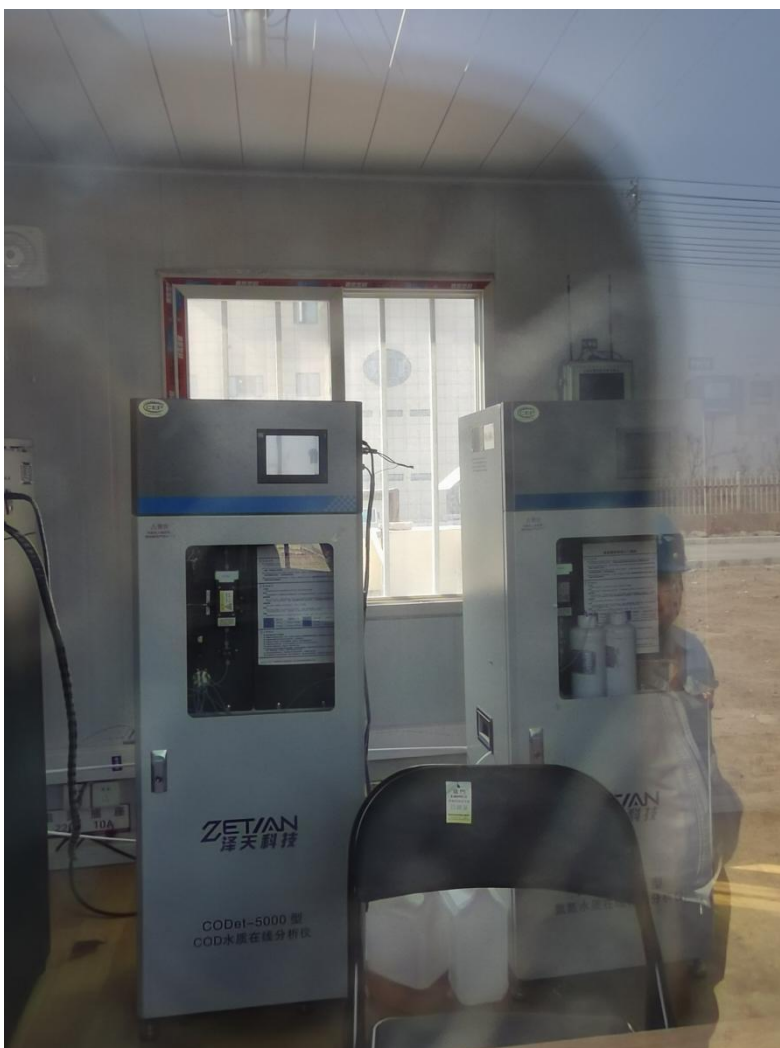
废水在线监测装置（外部）
