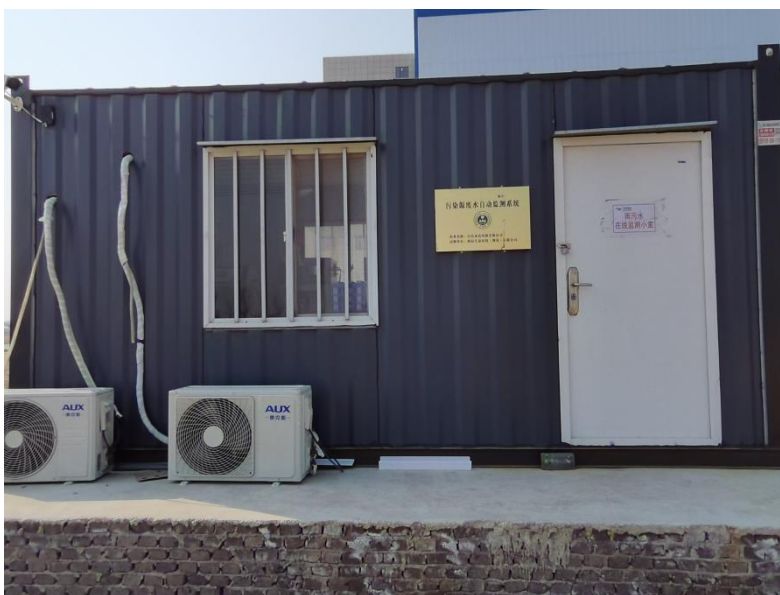
废水在线监测装置（外部）
