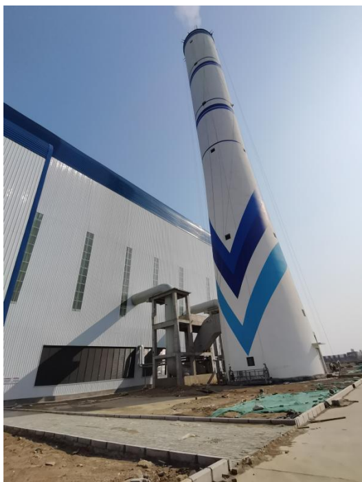
多筒集束排气筒 DA001、DA002
